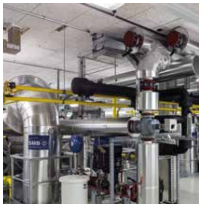
Abb 31: LKH-Univ. Klinikum Graz, Energiezentrale © Markus Kaiser
